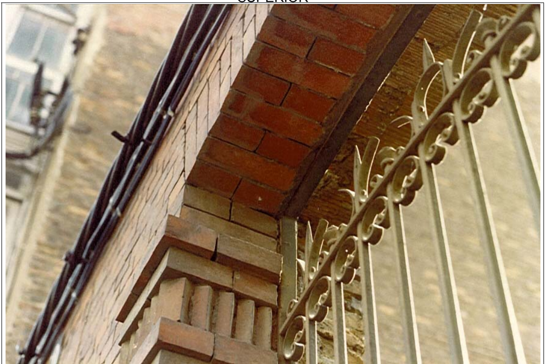
DETALLE DEL ARCO DE CIERRE DE UNO DE LOS HUECOS DEL CERRAMIENTO SUPERIOR
