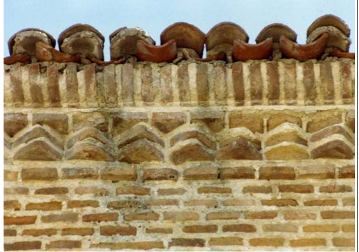
ALERO (arriba) Y SOLUCIÓN EN ESQUINA (abajo) DEL ALERO DE LA IGLESIA DE MURIEL DE ZAPARDIEL, VALLADOLID.
