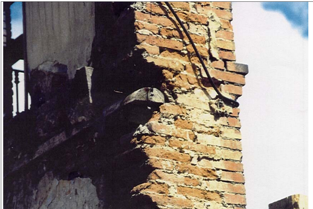
EDIFICIO DERRIBADO DE LA CALLE DE LA ESTACIÓN DONDE SE PUEDE APRECIAR: COMO APOYAN LAS VIGUETAS EN UNA SOLERA, LA CORNISA DE CINCHA ESTÁ AL NIVEL DE LAS VIGUETAS Y LOS LADRILLOS ENTEROS Y TERCIAJOS QUE FORMAN EL REVESTIMIENTO
