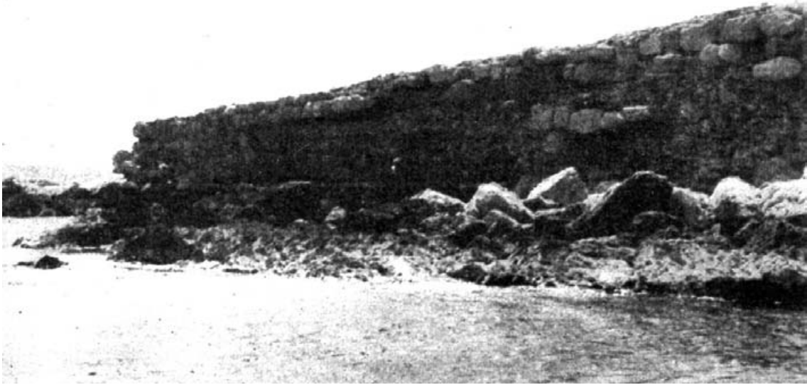
Estado actual del muelle, enormemente descarnado en su lado exterior, hacia el mar.
