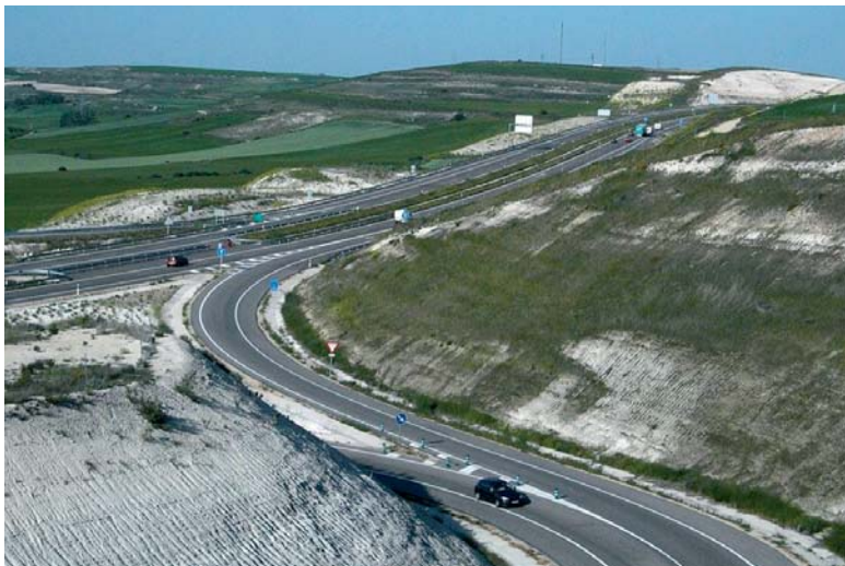
Ejemplo negativo de taludes desprovistos de vegetación, donde ya se observa la aparición de pequeñas cárcavas debido a la elevada erosión hídrica
