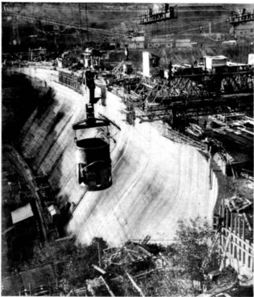
En febrero de 1948 entró en servicio la mayor y más potente presa de Europa: la de Génissiat, en el Ródano (v. arriba). La obra, comenzada en 1936 e interrumpida por la guerra, mide 104 metros de altura, tiene 180 metros de anchura, su espesor en la base es de cerca de 100 metros y representa una cubicación de 650.000 metros cúbicos de cemento. Una vez estén terminadas todas las instalaciones, la producción anual de Génissiat será de dos millones de kilowatios. Las principales presas del mundo en la actualidad son: la de Boulder-Dam (cinco mil millones de kilowatios hora); la de Grande-Coulée (once mil millones), y la de Dneiprostroi (tres mil doscientos millones). Para comprender su importancia social basta recordar la admirable obra realizada por las 20 presas que, en menos de diez años, han transformado el valle árido y devastado de Tennessee en una región rica y próspera, gracias a los trabajos de la T.V.A. (Foto United Press.)
