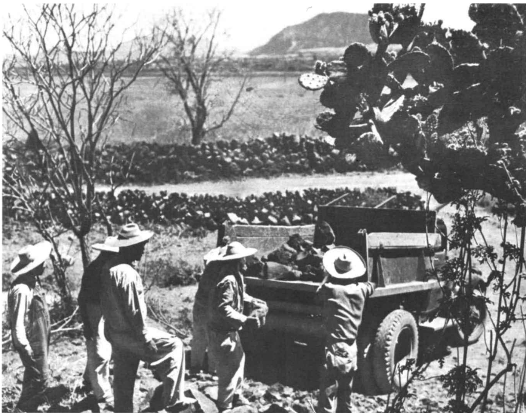
Bajo el sol candente, a orillas del Lago Pátzcuaro, los aldeanos cargan las piedras destinadas a construir el camino que ellos mismos han decidido hacer.
