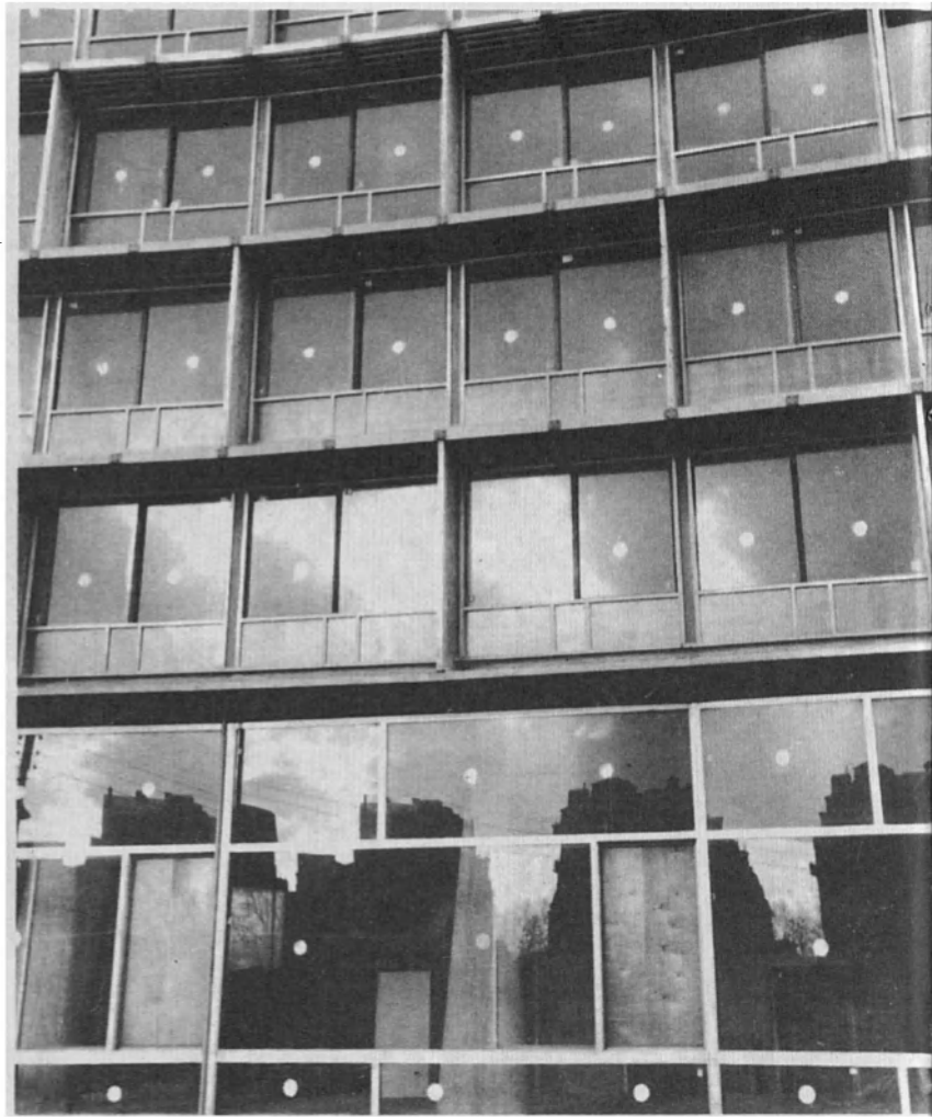
UNA CASA DE VIDRIO. Entre el 14 de abril de 1955, fecha de la primera paletada, y los últimos días de julio de 1958, en que se terminó lo más fundamental de la obra, el "cuartel de Fontenoy" ofreció al público parisiense el espectáculo de una cantera gigantesca en donde
