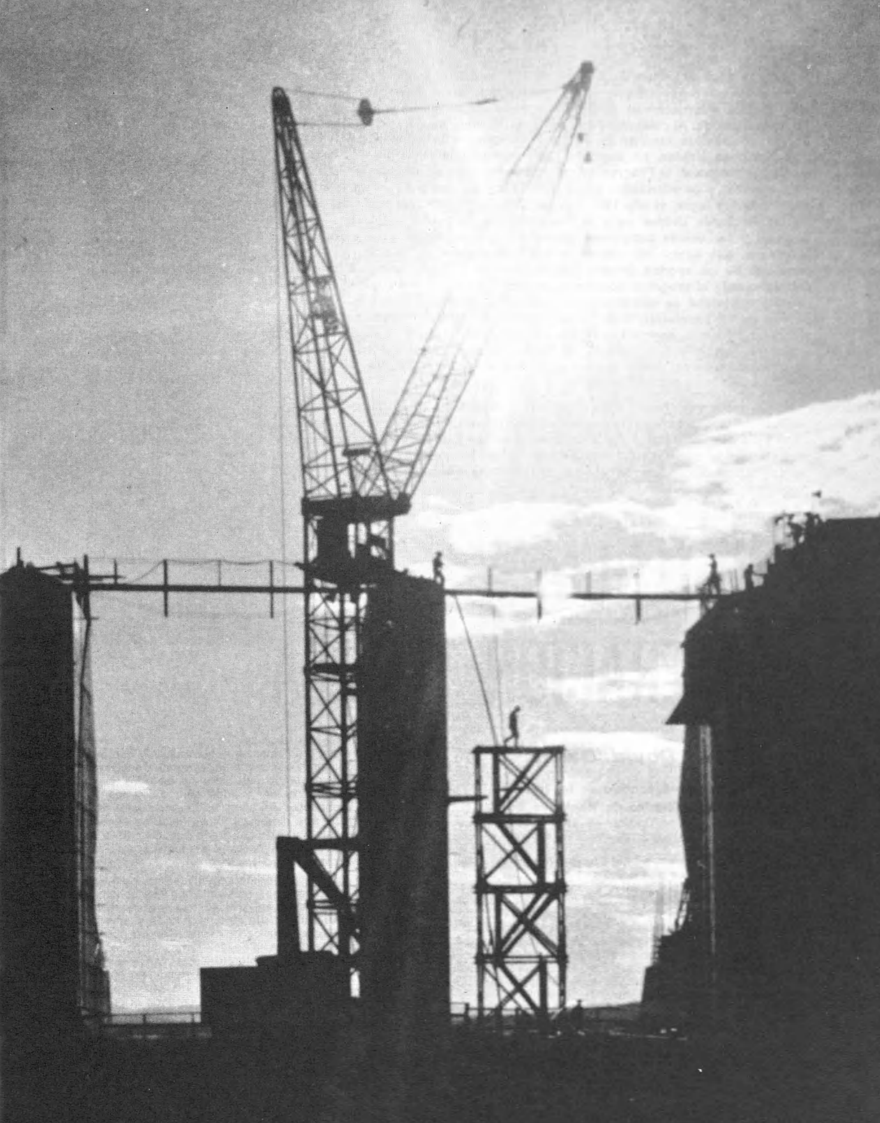
Construcción de la planta hidroeléctrica de Furnas en Río Grande (Brasil). Foto Banco Mundial - J. R. Nonato
