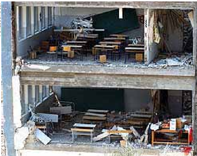
Escuela destruida en Bing Jbeil, Libano.
