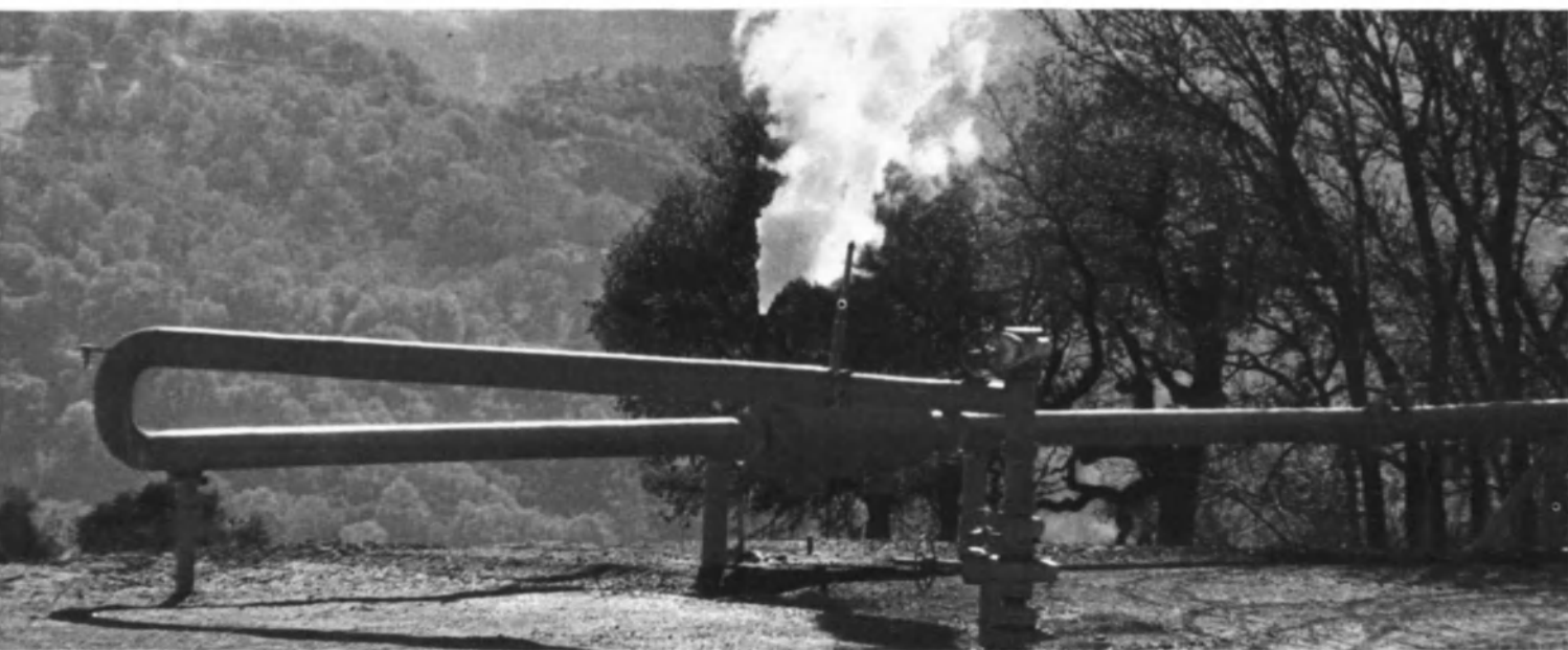
Géiser de agua caliente utilizado para obtener energía geotérmica.
