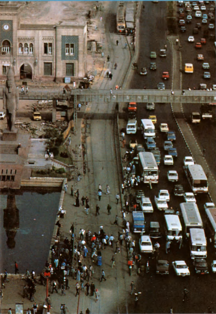
Construcción, terminada actualmente, de una vía para tráfico rápido que atraviesa el centro de El Cairo.
