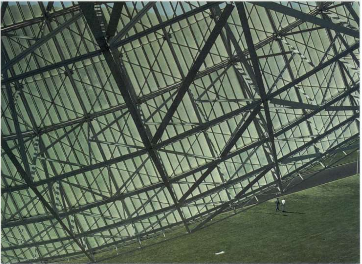
Estación de control espacial de Tidbinilla, en Nueva Gales del Sur, Australia.
