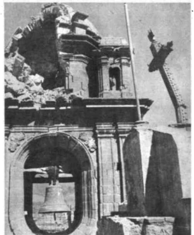
La Iglesia de la Compañía (construida por los Padres Jesuitas), como la de la Merced, la de San Sebastian la Catedral y otras, sufrieron los embates del temblor, y a pesar de la gran solidez de su construcción, que puede apreciarse bien en esta foto, donde vemos la torre derecha de la primera de las mencionadas Iglesias (la de la Compañía), cuya parte superior izquierda queda demolida y cuarteado gravemente todo el resto del edificio. En la parte derecha de la foto aparece el estado en que quedó la gran cruz de piedra labrada de la fachada principal de la iglesia.
