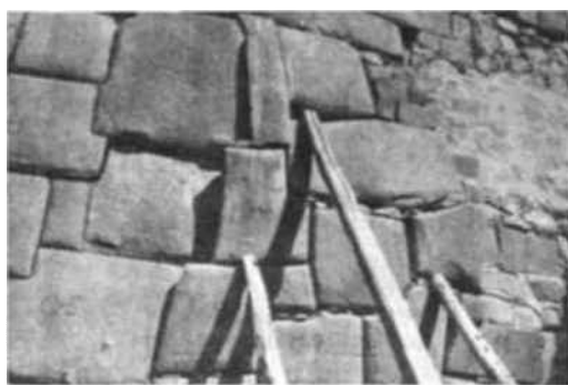
He aquí como ha quedado la muralla incaica de tipo ciclópeo de la calle Atun-Rumico de El Cuzco, después del sismo que azotó la ciudad el 21 de Mayo. Las grandes losas pétreas que habían resistido el decurso de los siglos y numerosos temblores de tierra, se desprendieron de sus sujeciones de argamasa, cayeron al suelo y fué necesario numerarlas para rehacer el revestimiento. En la foto se aprecia bien la clase de trabajo que los arquitectos peruanos precolombinos realizaron a fin de defender de la ciudad imperial.
