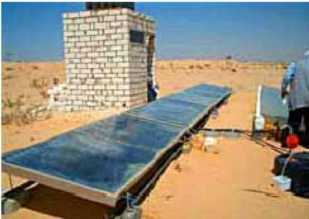
Sistema de desalinización a base de energía solar.
