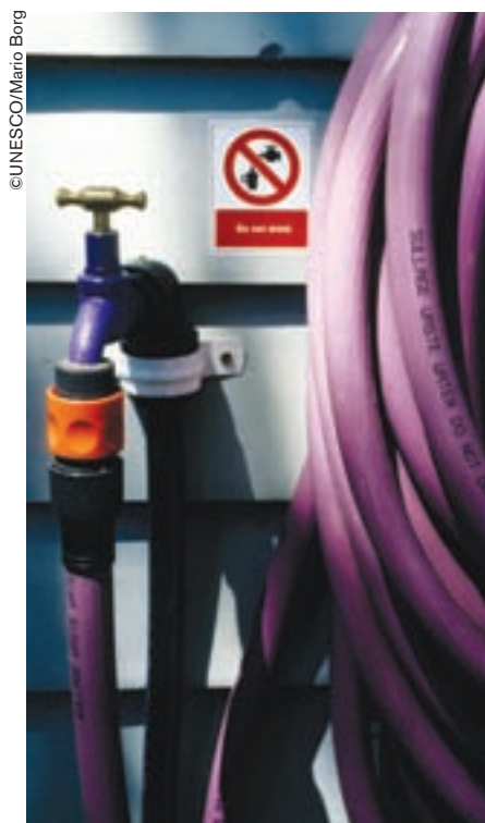
Tuberías para aguas residuales, Melbourne, Victoria, Australia.
