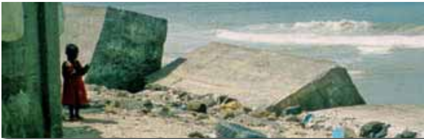
Socavado por el oleaje, el muro de Rufisque se derrumbó.
